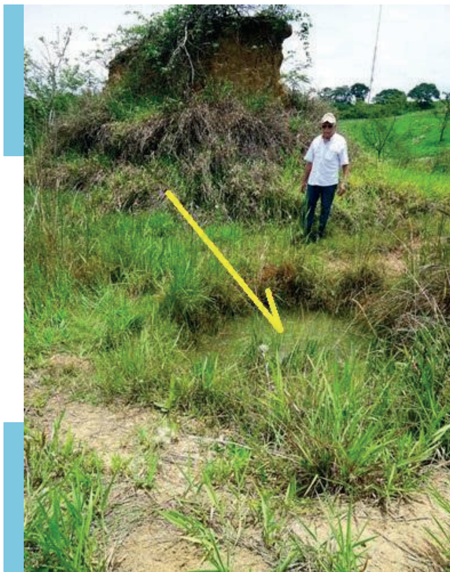
Olho d'água originado de escavação para retirada de solo em área de empréstimo. Atentar para o morrete-testemunho que indica o nível original do terreno antes das escavações.
